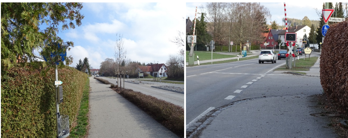
Abb. 44: Verdeckte und beschädigte Verkehrszeichen
