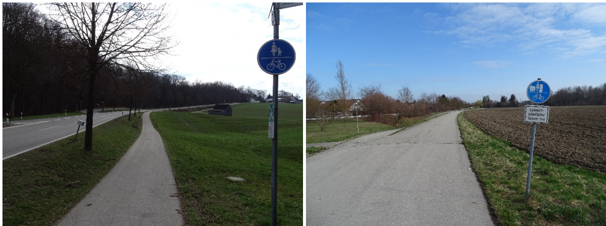
Abb. 42: Zu schmal dimensionierter Radweg (links); Radwegebreite entspricht den Qualitätskriterien (rechts)
