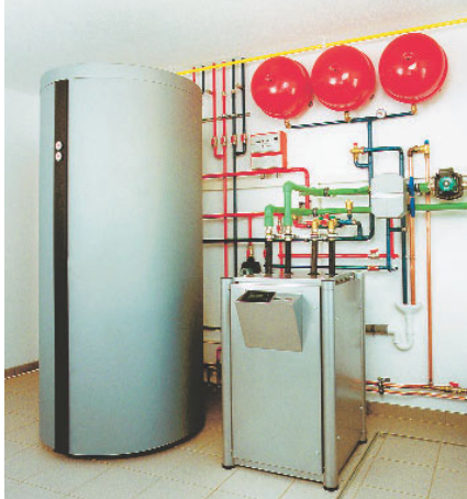
Erdwärmepumpe (Sole/Wasser) zum Heizen und zur Warmwasserbereitung in einem Einfamilienhaus.
